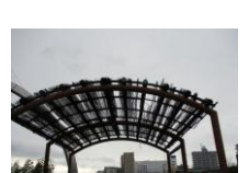
公園橋/少し壊れた日除け
