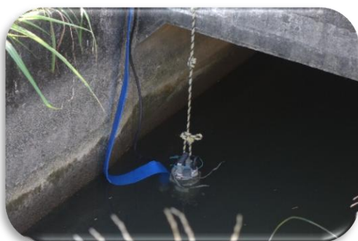
道路脇水路の水中ポンプ
